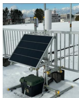
図 9 太陽光パネルによる基地局の設置。
